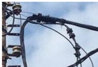
Figura 3: Dois conectores redundantes usados em uma conexão de neutro.
